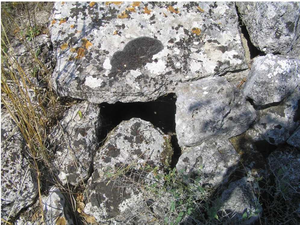
Fig. 12 _Vera in muratura di accesso alla cisterna.
