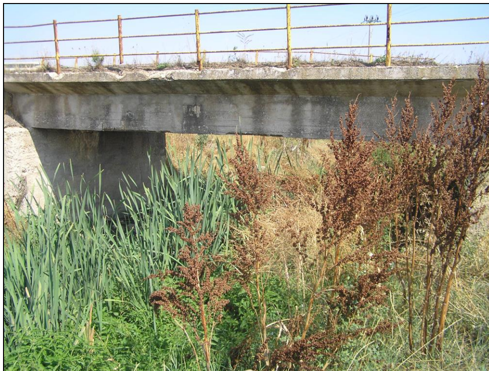
Fig. 3 _Ponte della strada comunale n. 106 di attraversamento del canale visto da est.
