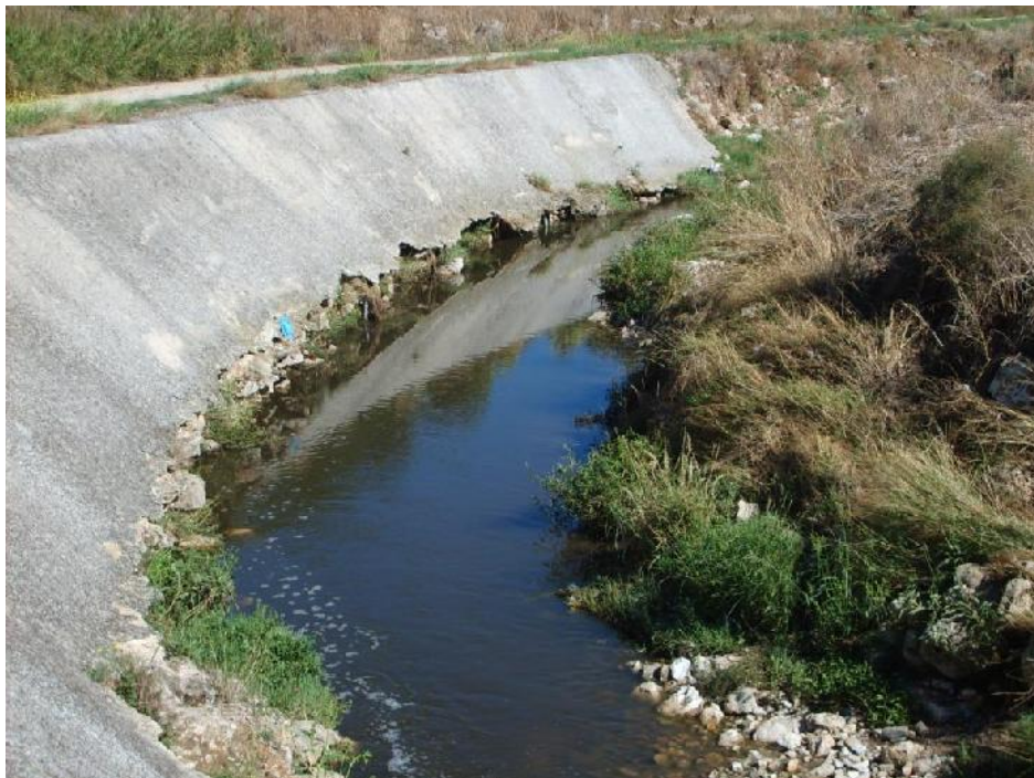
Particolare dello scalzamento al piede del rivestimento in cls esistente
