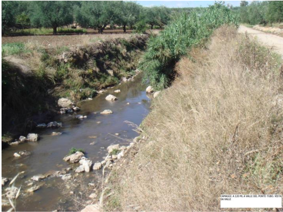
Particolare erosione in sponda dx idraulica
