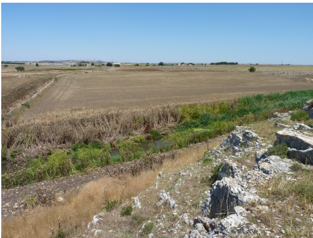
Foto 14 – Tratto del canale Jesce con sezione non risagomata
