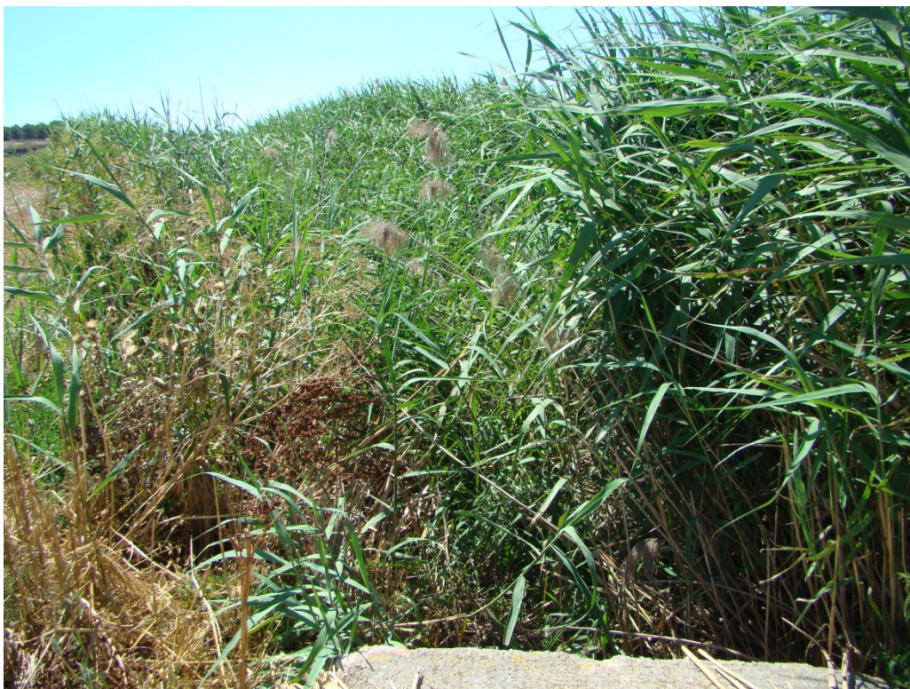
Foto 11 – Tratto del canale Jesce con sezione non risagomata
