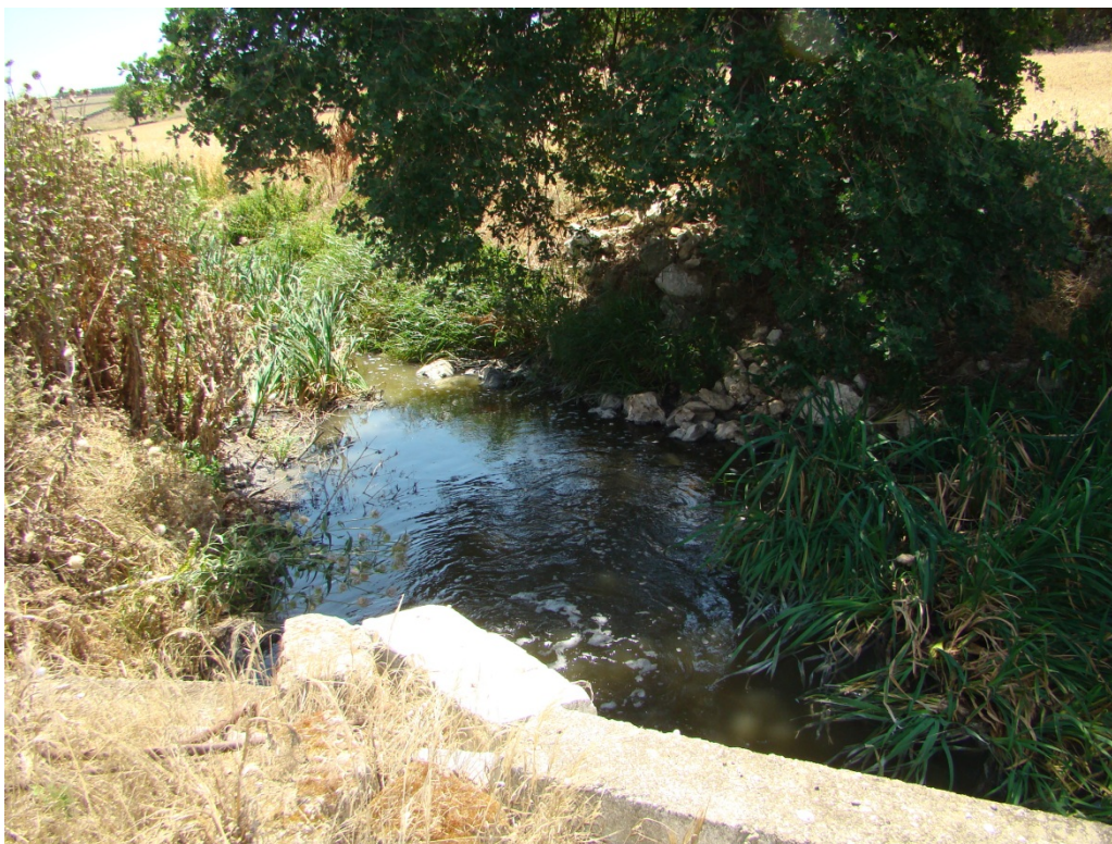
Foto 15 – Tratto del canale Jesce con sezione non risagomata
