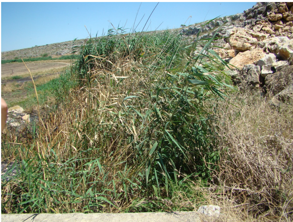
Foto 19 – Tratto del canale Jesce con sezione non risagomata
