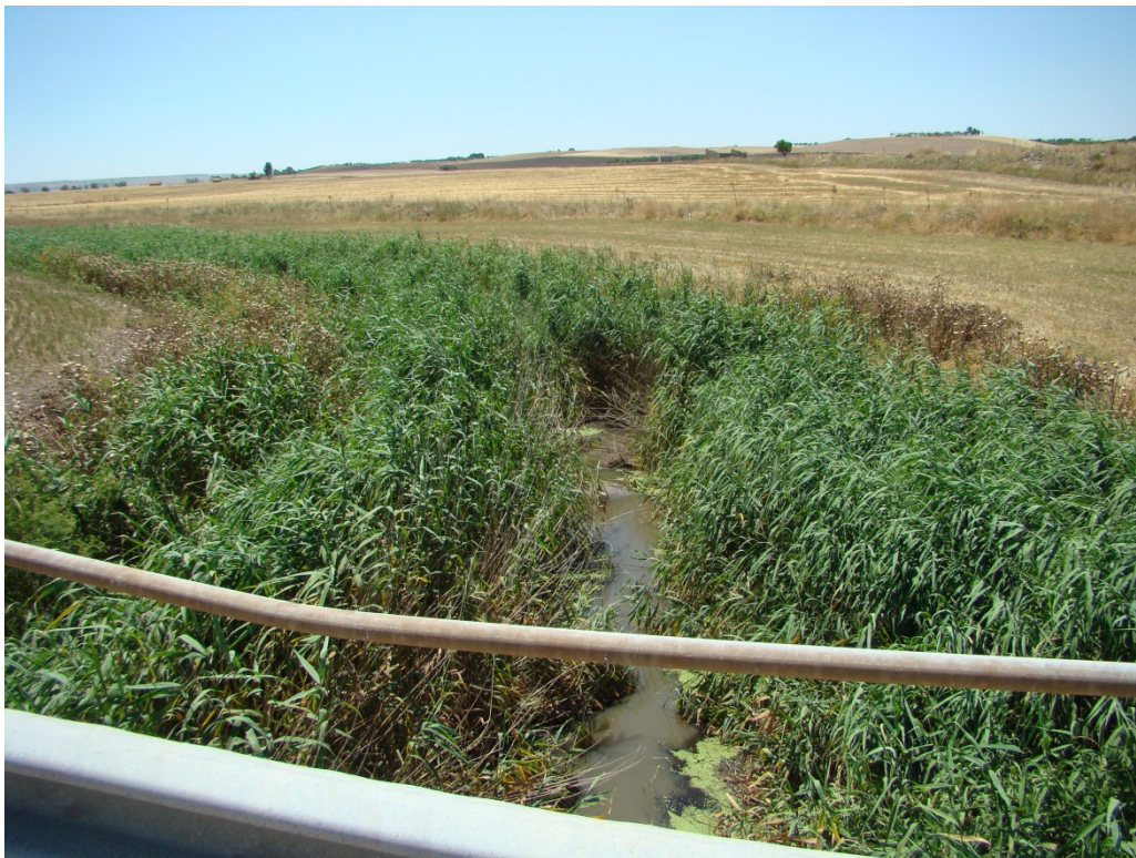
Foto 21– Fine tratto del canale Jesce con sezione non risagomata ed inizio tratto con sezione risagomata
