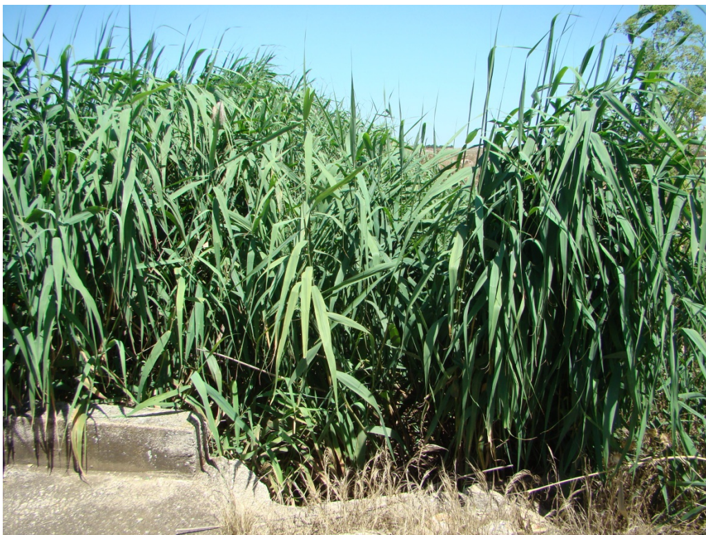
Foto 16 – Tratto del canale Jesce con sezione non risagomata
