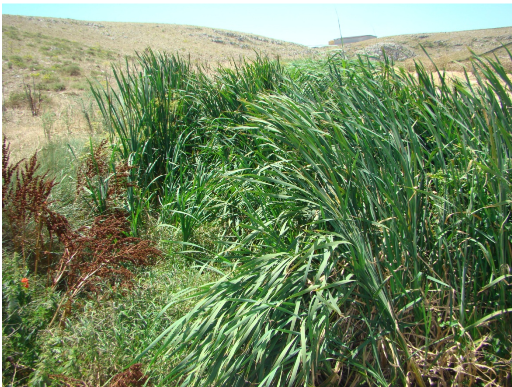
Foto 18 – Tratto del canale Jesce con sezione non risagomata
