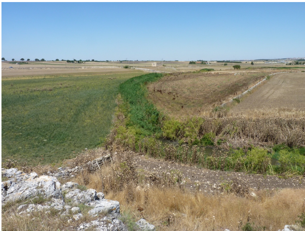
Foto 13 – Tratto del canale Jesce con sezione non risagomata
