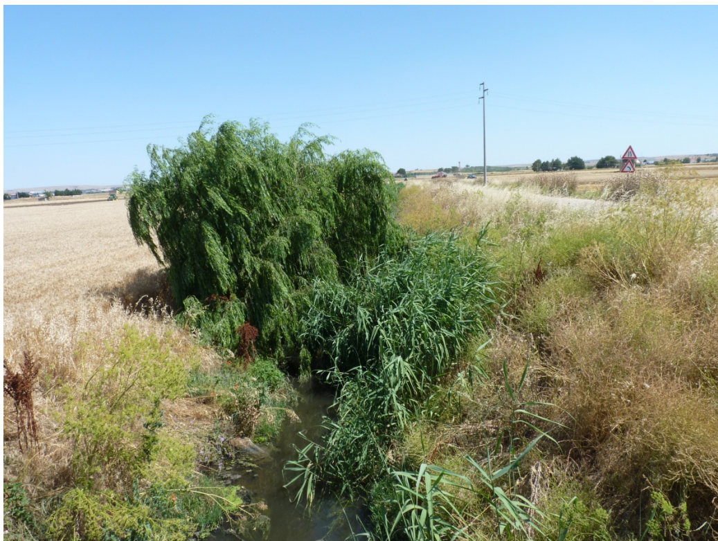
Foto 4 – Tratto del canale Jesce con sezione risagomata e vegetazione al fondo
