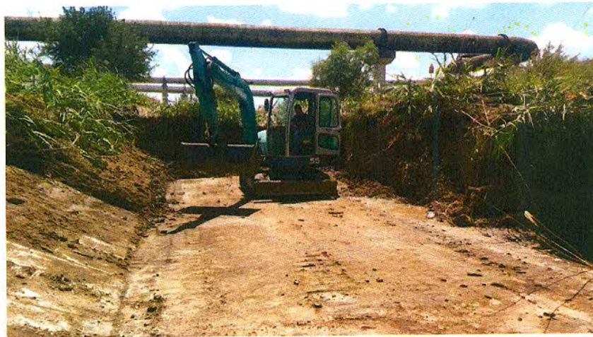
Foto 4 – Tratta oggetto della presente perizia - Saggio effettuato nel corso dei lavori. Il piano di lavoro coincide con il piano della golena. Sotto al materiale in vista giace il deposito altro materiale per un'altezza di mt 1,70 (savanella)
