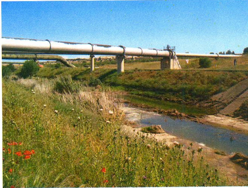
Foto 3 – Tratta oggetto della presente perizia, ristagno di acqua
