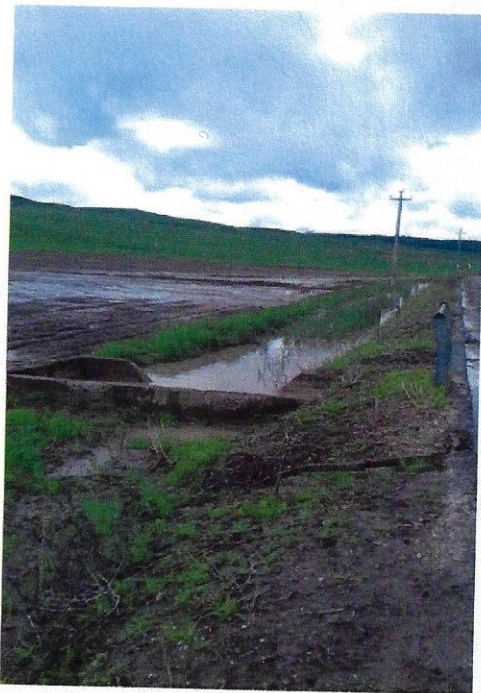
Foto scattata in data 15 aprile dalla s.p. ex n° 5 – Straripamento del pozzetto di raccolta delle acque del fosso di guardia della stessa strada a causa dell'elevato livello idrico del torrente Locone
